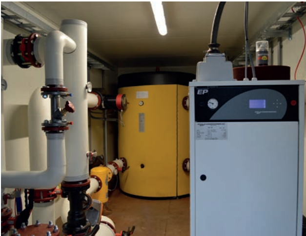
△ Het buffervat en de elektrische ketel in de technische ruimte.
